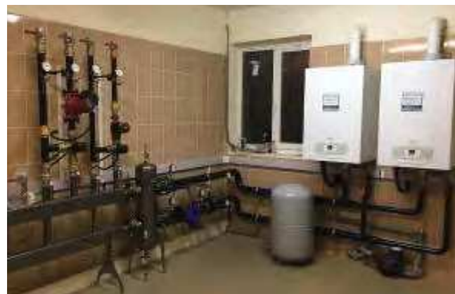
Автосервис, г. Москва Общая мощность котельной - 300 кВт
