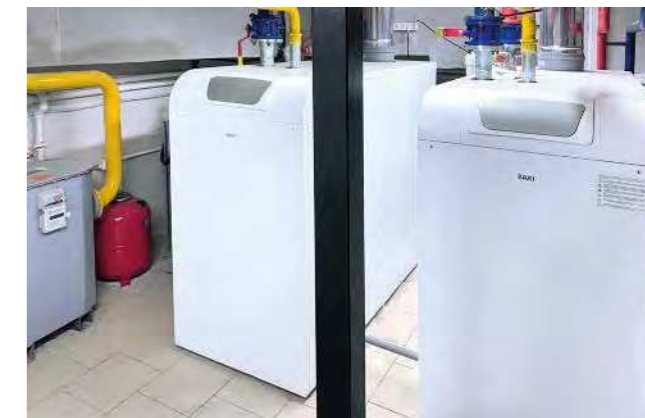
Ресторан Black Star Burger, г. Махачкала Общая мощность котельной - 860 кВт
