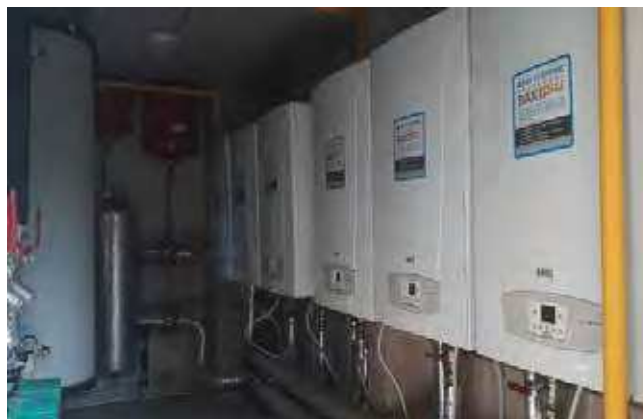
Торговый центр, г. Сочи Общая мощность котельной - 600 кВт
