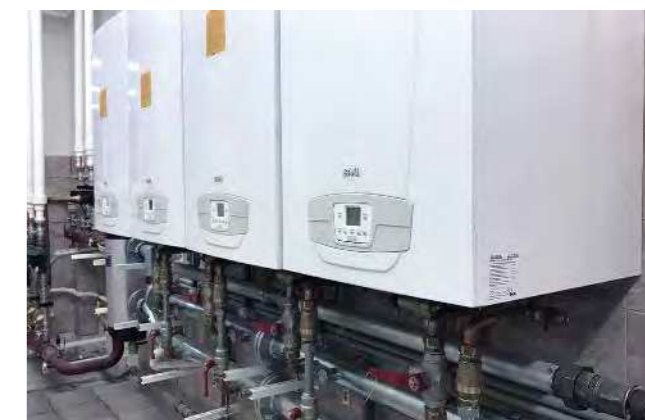
Общежитие, г. Усть-Луга Общая мощность котельной - 300 кВт
