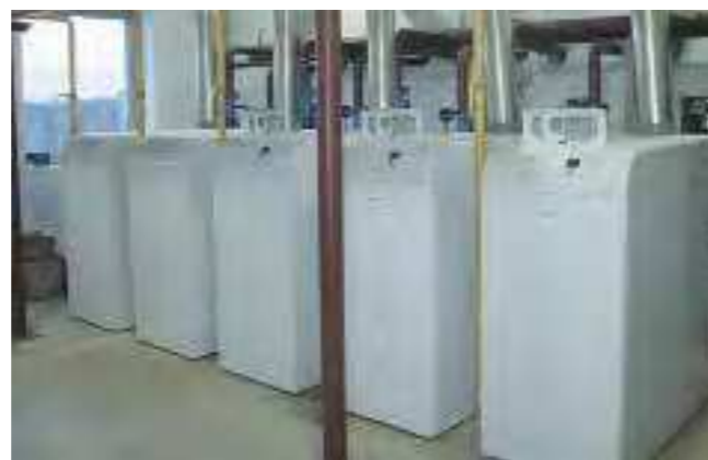
Кинотеатр, г. Йошка-Ола Общая мощность - 1,6 МВт
