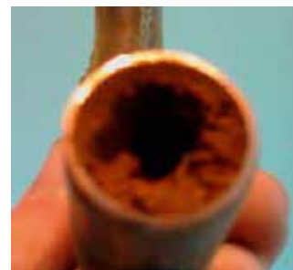
Окисные отложения в трубах
